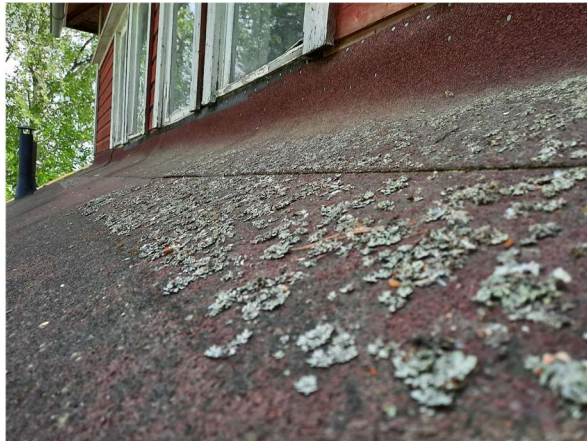
Päärakennuksen auringon vastaisilla kateilla kasvaa sammalta.
