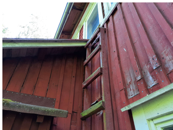
Päärakennuksen kunnostamatonta julkisivua.
