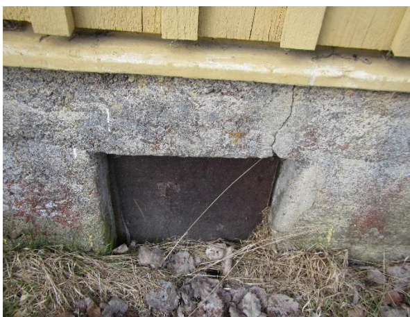
Kuva 30. Lähes kaikki alapohjan tuuletusaukot on tukittu, eikä niitä ole tarpeeksi suhteessa alapohjan pinta-alaan.
