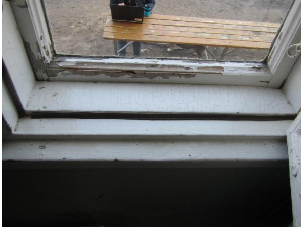
Kuva 49. Rakennuksen ikkunoiden maalipinnat ovat heikossa kunnossa, etenkin ulkopuitteen osalta.
