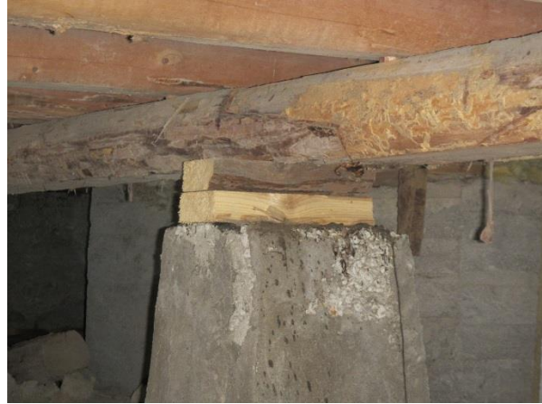
Kuva 21. Perustukset ovat painuneet ajansaotossa. Perustuksen ja rungon väliin on asennettu korotuslankut.
