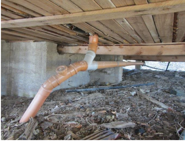
Kuva 112. Saunarakennuksen pohjaviemäri on ulkoilmassa ja täysin eristämätön
