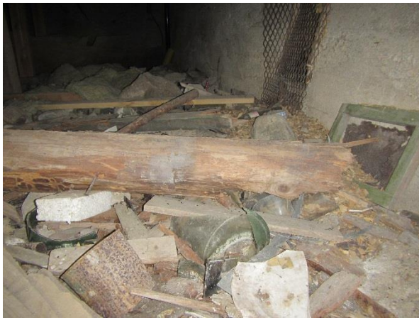
Kuva 28. Ryömintätallassa on paikoin paljon rakennusjätettä ja roskaa.
