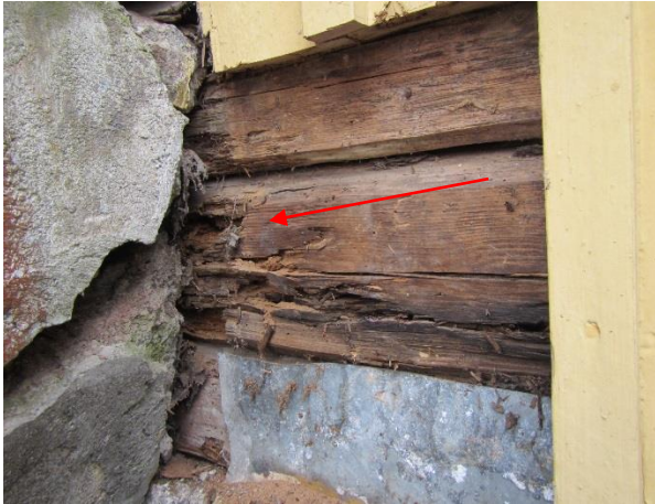
Kuva 39. Hirsirungossa on lahoa ulkoportaikon kohdalla.
