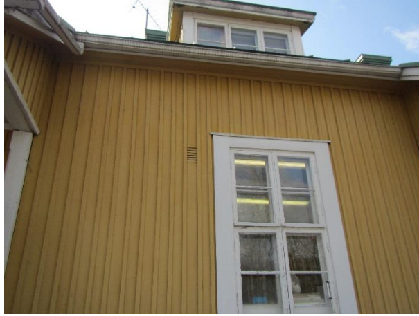
Kuva 122. Ulkoseinässä keittiön johtava korvausilmaventtiili
