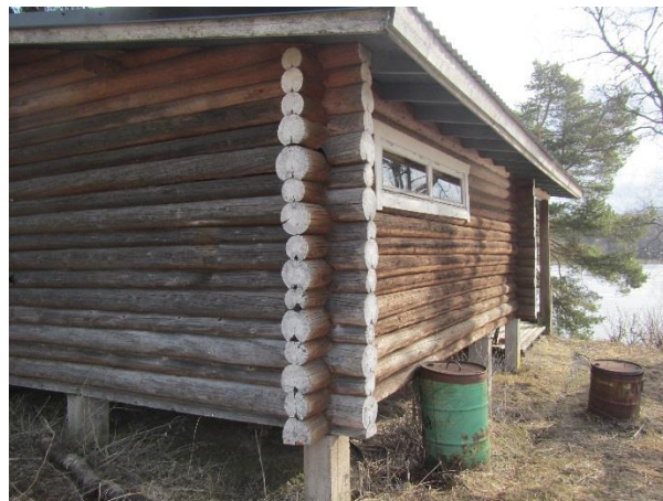
Kuva 38. Hirsirungossa ei silmämääräisesti havaittu lahoja kohtia.
