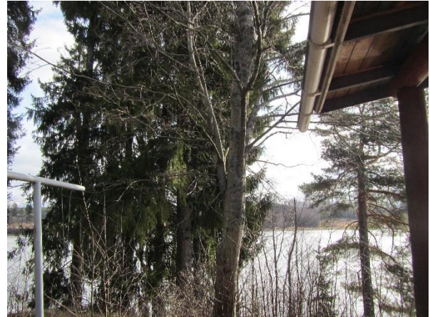
Kuva 3. Yksittäinen puu on liian lähellä rakennusta. Lehdet tukkivat vesikouruja.
