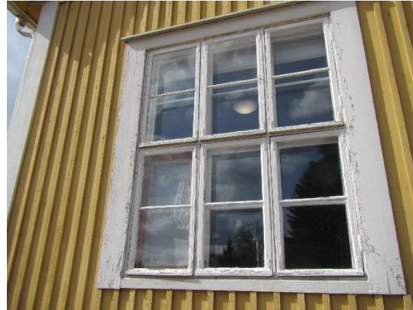
Kuva 54. Ikkunoiden puuosien maalipinnat hilseilevät
