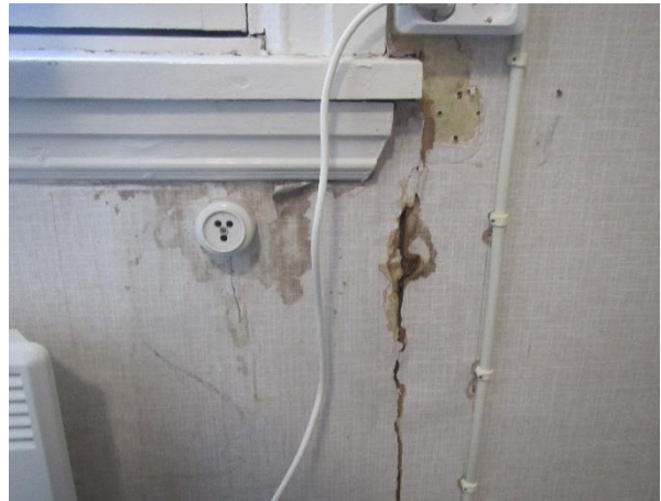
Kuva 83. Yläkerran seinälevytyksessä halkeama, jossa ilmavuoto. Puhelinpistorasian kohdalla myös vesivuodon aiheuttama tummempi alue
