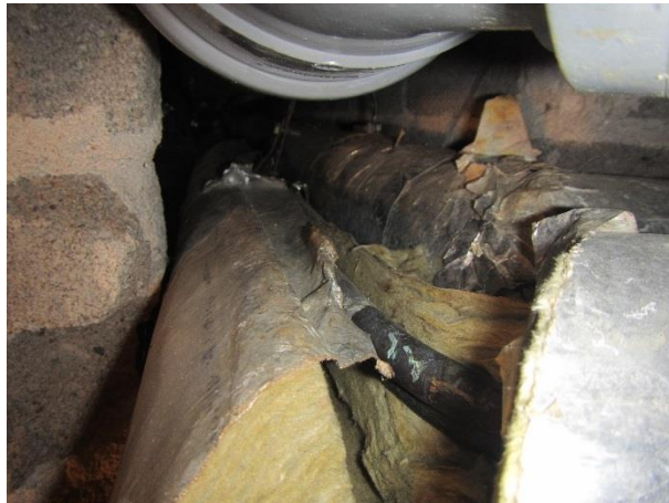
Kuva 99. Kylmissä tiloissa olevat vesijohtoteristeet ovat paikoittain puutteelliset tai rikkoutuneet
