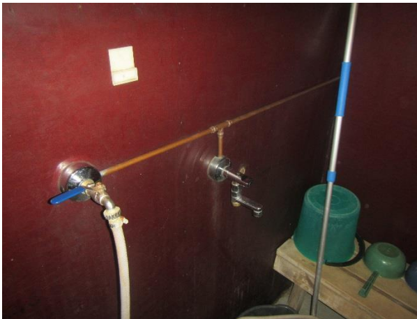
Kuva 102. Saunarakennuksen käyttövesipisteet ja näkymää vesijohdosta
