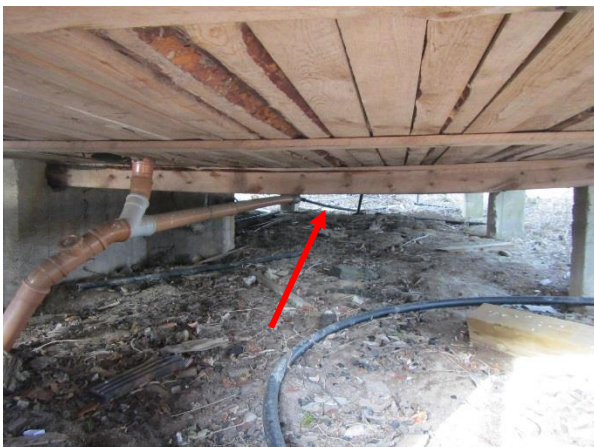
Kuva 22. Alapohjan rakenteissa painumaa
