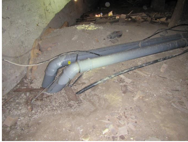
Kuva 113. Päärakennuksen alapohjassa olevat jätevesiputket ovat eristämättömät
