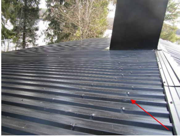
Kuva 62. Vesikatteessa ihmisen painosta tulleita painumia.
