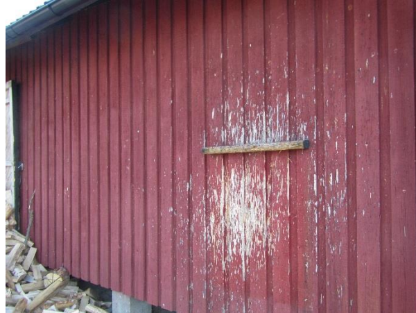
Kuva 42. Tikkataulun kohdalla julkisivu on heikossa kunnossa.
