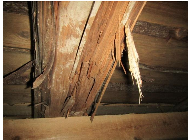
Kuva 29. Alueella jossa on tehty lisätuentoja, havaittiin lahoja puupalkit.
