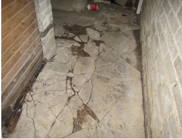
Kuva 32. Kellarin alapohjarakenteena toimii eristämätön ohut betonilaatta, joka on halkeillut/routunut pahasti.
