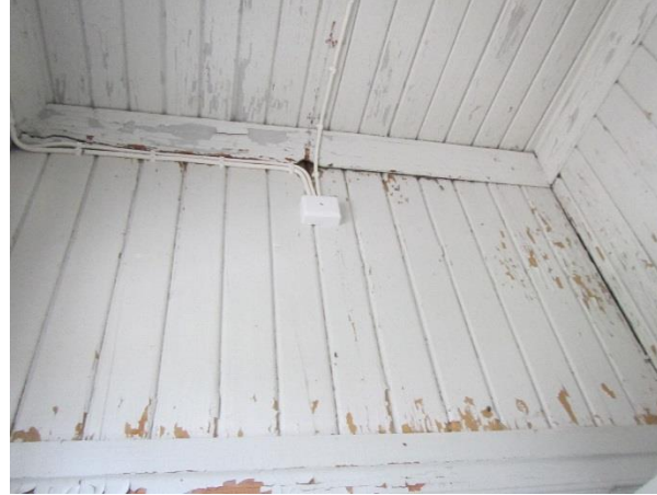
Kuva 85. Rakennuksen päädyssä olevan kylmän kuistin panelointi on heikossa kunnossa.
