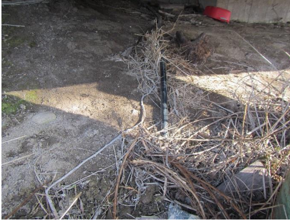
Kuva 104. Vesijohto kulkee eristämättömänä saunarakennuksen alla
