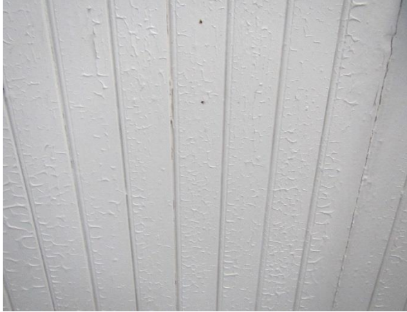
Kuva 84. Yläkerran kattopaneloinnin maalipinnat ovat heikossa kunnossa
