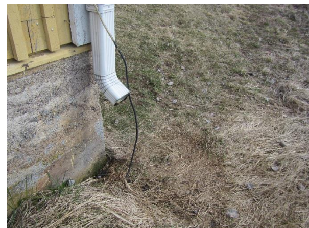
Kuva 14. Katolta tulevat sadevedet valuvat suoraan rakennuksen vierustalle.
