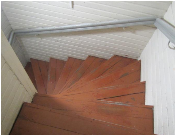
Kuva 88. Portaikko on maalattua lautta, jonka maalipinta hilseilee
