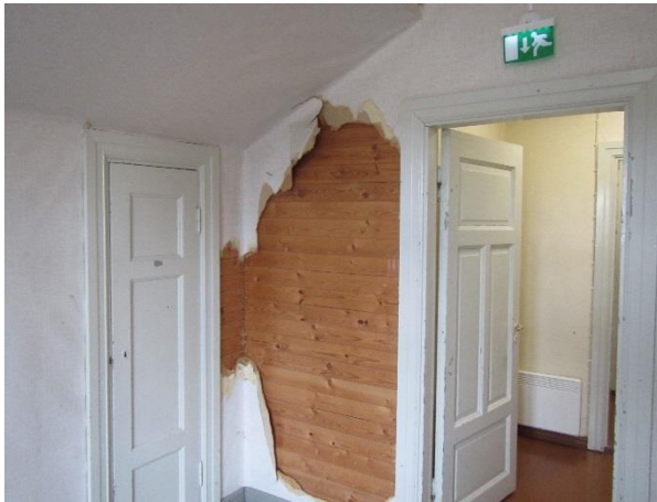
Kuva 82. Yläkerran seinäpinnat ovat monin paikoin huonossa kunnossa
