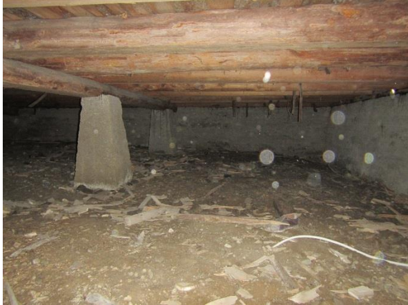
Kuva 26. Yleiskuvaa alapohjatilasta. Alapohjatilassa jonkin verran ylimääräistä roskaa ja rakennusjätettä.
