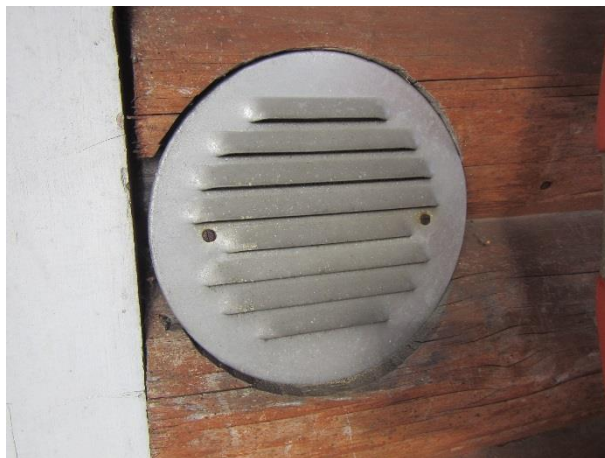
Kuva 120. Saunarakennuksen ulkoseinällä oleva korvausilmaritilä
