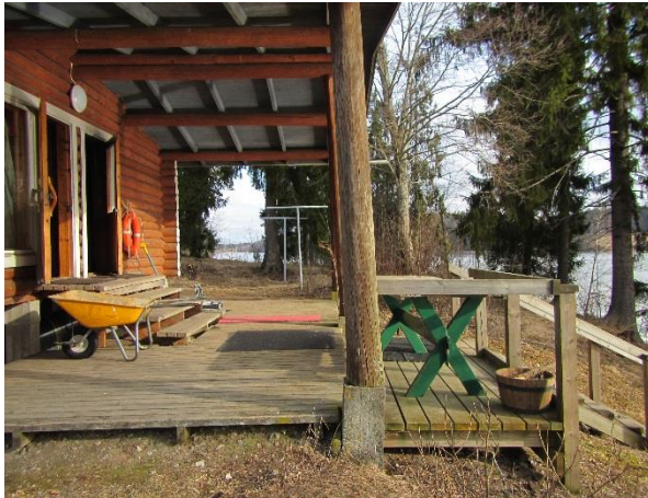
Kuva 35. Terassin pystyhirsyä ei ole kiinnitetty betonianturoihin ja ne ovat kallistuneet.
