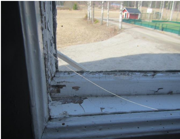
Kuva 51. Useassa lasissa havaittiin halkeamia
