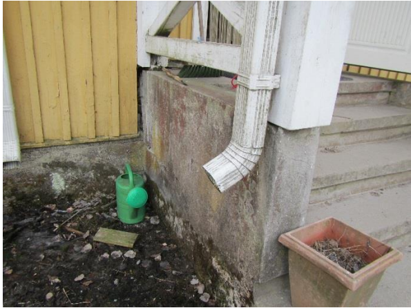
Kuva 73. Sadevedet on ohjattu suoraan rakennuksen vierustoille.
