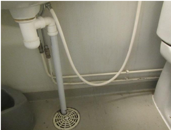
Kuva 98. Vesikalusteelle menevät jakojohdot ovat varustettu kalustesuluin
