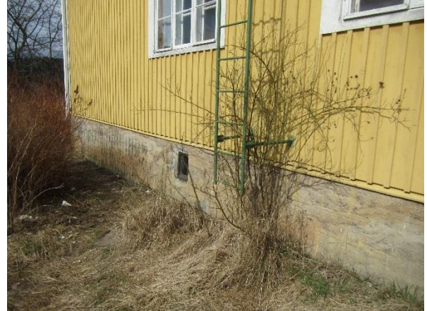
Kuva 10. Rakennuksen takana on kasvillisuutta liian lähellä rakennusta.
