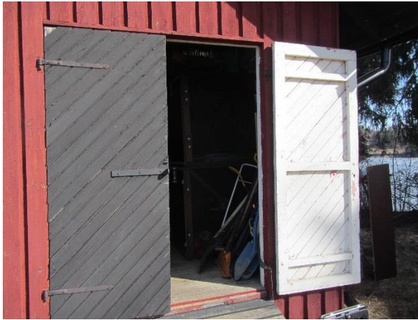
Kuva 56. Piharakennuksessa on puiset ladonovet, joiden maalipinta on välttävässä kunnossa.
