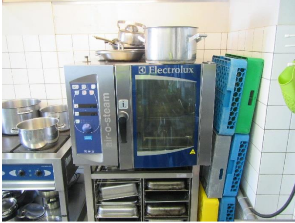
Kuva 135. Näkymä keittiön laitteesta.
