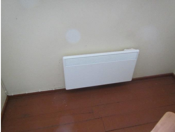
Kuva 95. Sähköpatteri, jossa on integroitu termostaattisäädin
