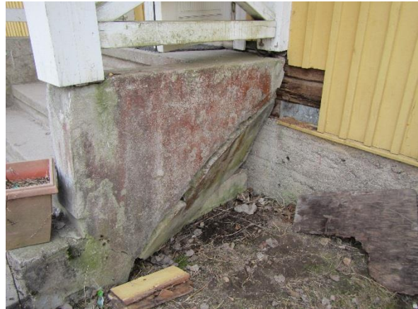
Kuva 61. Ulko-oven edustalla oleva betoniporras on huonossa kunnossa
