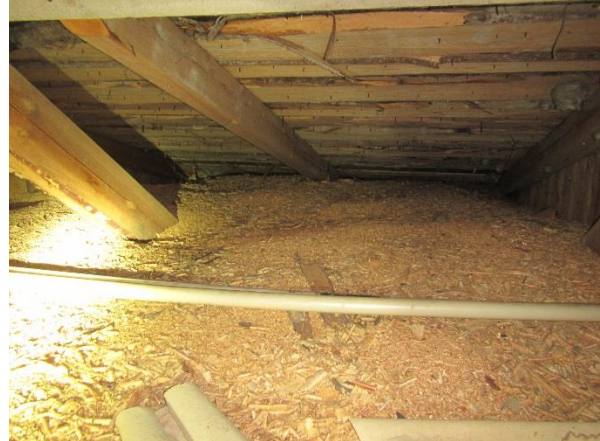
Kuva 70. Yläkerran kohdalla muodostuu paljon jäätä vesikatolla talvella. Tämä johtuu siitä että yläpohjan purueristeet ovat suoraan kiinni peltikatteessa/aluslaudoituksessa ja yläpohjan tuuletus on näin ollen puutteellinen.
