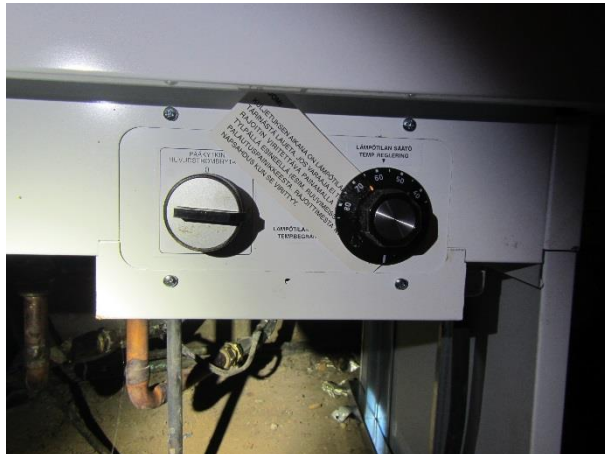
Kuva 97. Lämpimän veden lämpötilan säätö on asetettu noin 57-58°C:seen
