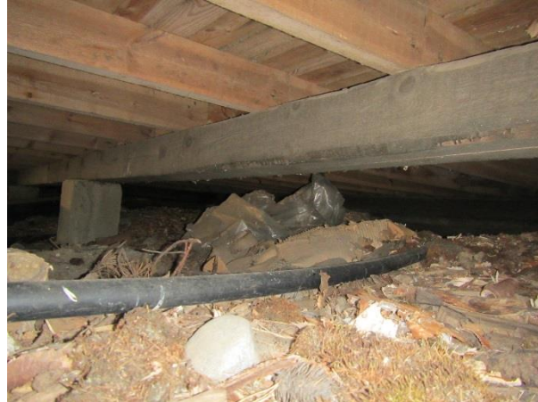
Kuva 25. Alapohjatilassa ylimääräistä roskaa ja orgaanista jätettä.
