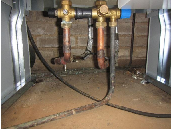
Kuva 100. Lämminvesivaraajan teknisen tilan vesijohdot saattolämmityksellä varustettuja
