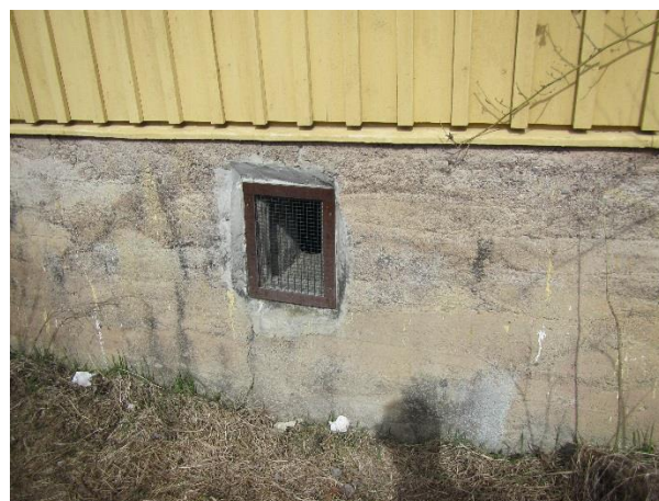
Kuva 31. Oikeaoppinen suojaverkolla varustettu alapohjan tuuletusaukko.
