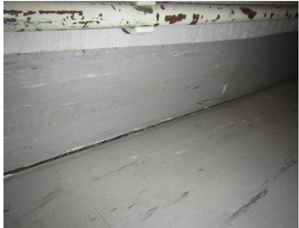
Kuva 91. Wc:n muovimatto on haljennut ja se ei ole enää vesitiivis
