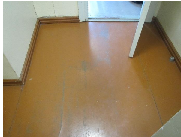
Kuva 89. Yläkerran lattiapinnoitteet ovat kuluneita pahvipinnoitteita tai maalattua lautalattia, joiden maalipinta lohkeilee ja hilseilee
