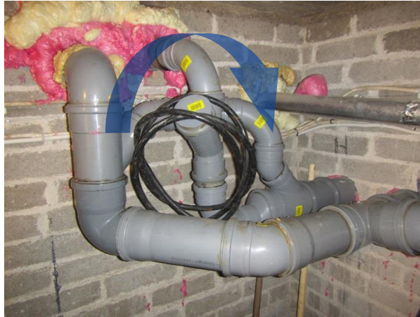
Kuva 115. Teknisessä tilassa harmaa-vesi- ja jätevesiviemäri on yhdistetty ilmeisesti ylivuodon takia toisiinsa
