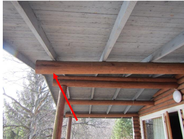
Kuva 36. Kahden kattovasasan alapuolella ei ole ollenkaan kannaketta/pystyhirsyä.
