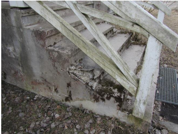
Kuva 60. Ulko-oven edustalla oleva betoniporras on huonossa kunnossa
