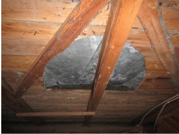
Kuva 69. Yläpohjatilassa on ollut aikaisemmin kattoikkunat, jotka on laitettu umpeen peltikatteen asennuksen yhteydessä.
