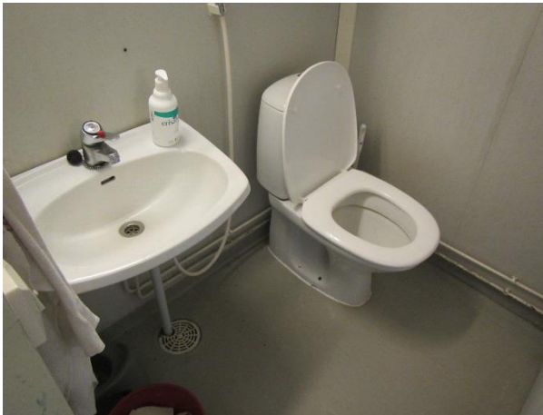
Kuva 108. Päärakennuksen vesi- ja viemärikalusteita
