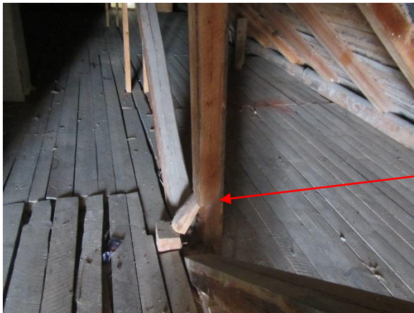
Kuva 67. Yläpohjan tukiparrun siirtymä.
