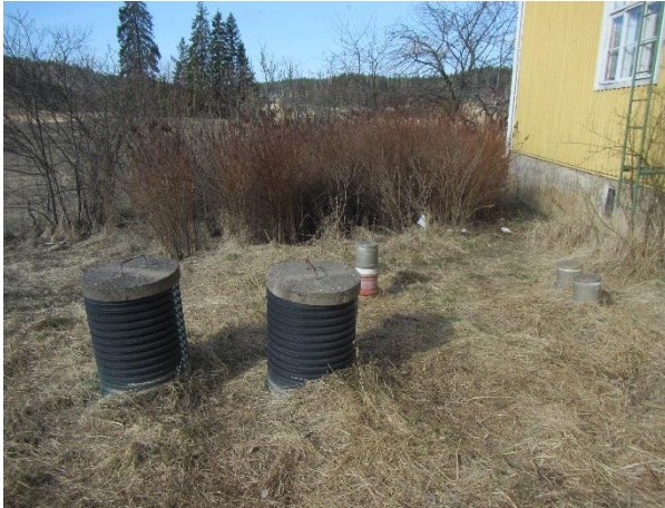
Kuva 110. Takapihalla oleva saostuskaivojärjestelmä ja siihen kuuluvat kaivot
