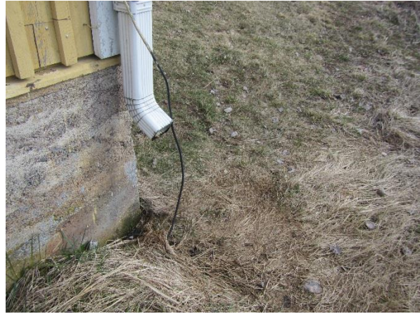
Kuva 74. Sadevedet on ohjattu suoraan rakennuksen vierustoille ja maanpinnan kallistukset ovat puutteelliset.
