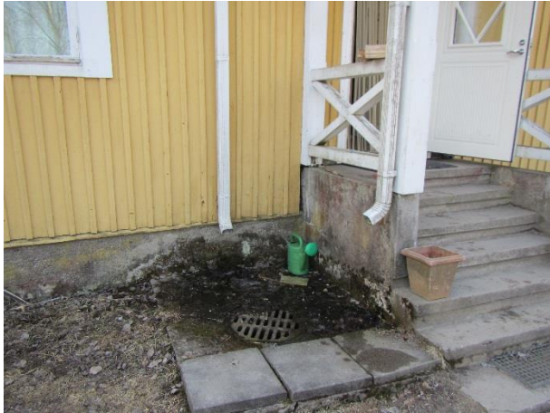
Kuva 116. Pihalla oleva ritiläkantinen sadevesikaivo
