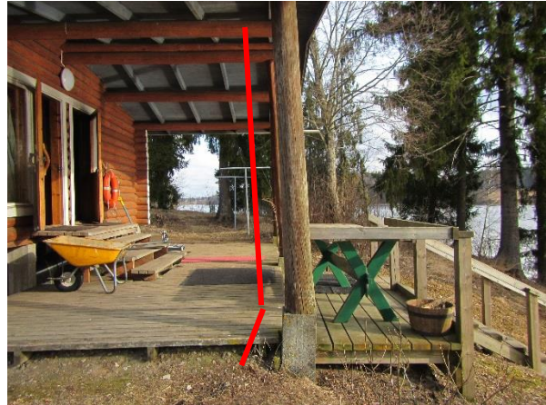
Kuva 17. Terassin kohdalla pilariperustukset ovat hieman vinoutuneet.
