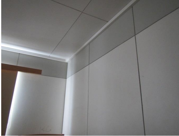
Kuva 80. Alakerran seinäpinnat ovat asbestipitoista maalattua lujalevyä
