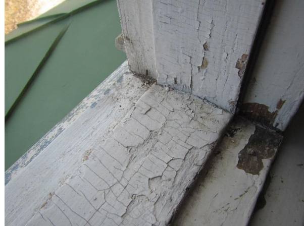
Kuva 50. Yläkerran ikkunat ovat vielä huonommassa kunnossa, koska tiloissa ei ole aina lämmitystä ja ikkunoihin kohdistuu myös suurempi säärasitus (aurinko + viistosade)
