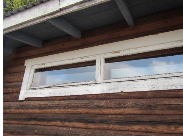
Kuva 46. Ikkunan puuosien maalipinta hilseilee ja alalistat ovat irronneet.
