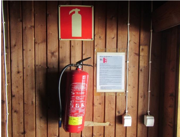
Kuva 123. Saunarakennuksen käsisammutin sekä hätäilmoitusohje tarkastettu
