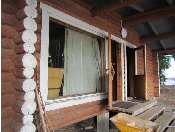
Kuva 45. Saunarakennuksen iso ikkuna, jonka maalipinta hilseilee alapuitteen osalta.
