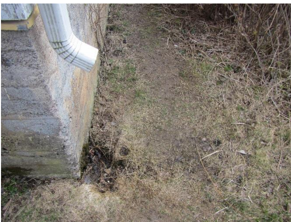
Kuva 13. Katolta tulevat sadevedet valuvat suoraan rakennuksen vierustalle.
