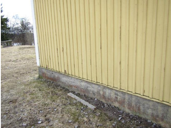
Kuva 20. Päärakennuksen betoniset sokkelit ovat kuluneet ajan saatossa ja vaativat huoltokorjausta.
