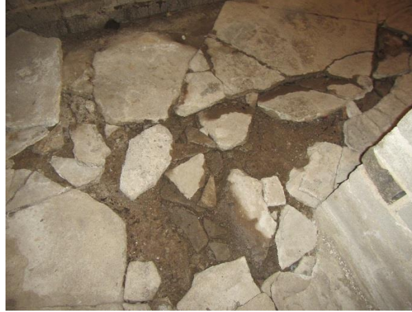
Kuva 33. Kellarin maanvastainen betonilaatta on todella huonossa kunnossa.
