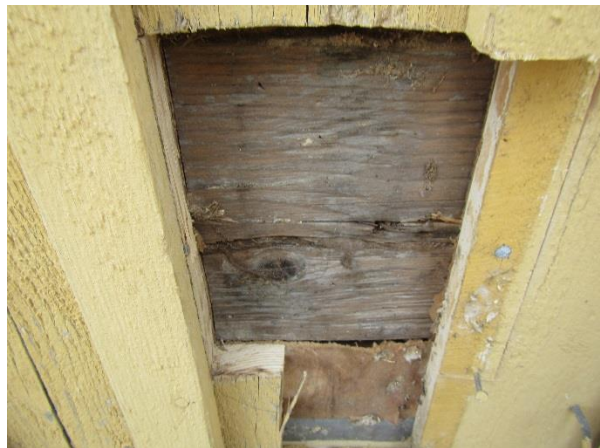
Kuva 44. Julkisivun laudoitus on kiinnitetty suoraan hirsirunkoon, eikä se pääse tuulettumaan edes peiterimojen kohdalla.
