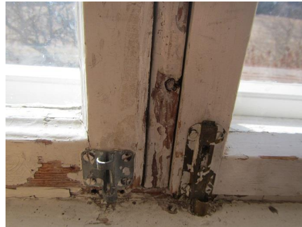
Kuva 52. Ikkunoiden kiinnitysmekanismit olivat paikoin jumissa ja heikossa kunnossa
