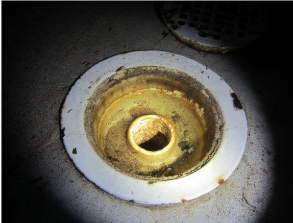
Kuva 106. Saunarakennuksen lattiakaivo on vanha hiekanerotin-mallinen
