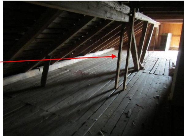
Kuva 66. Katon rakenteisiin laitettu lisätuentaa ajansaatossa ja kaksi vetotankoa poistettu toiselta puolelta
