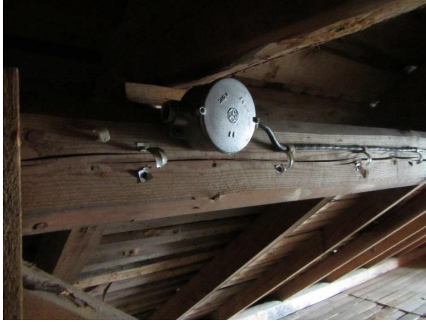
Kuva 131. Näkymä osittain purettu kaapelista.
