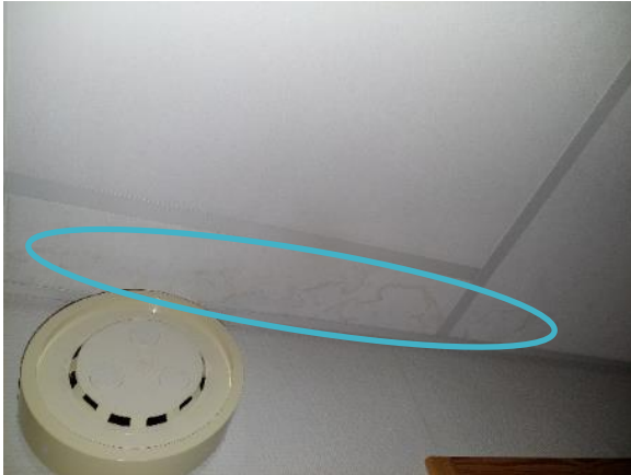
Kuva 77 Vuotojälkiä äänenvaimennuslevyissä käytävällä 1.45 henkilökunnan sosiaalitalan vieressä.
