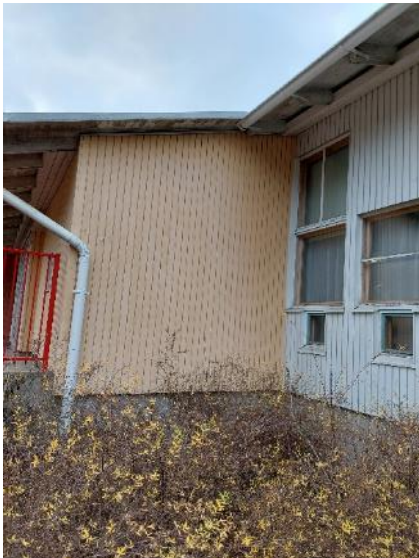
Kuva 23 Rakennuksen 2 sisäpihan puoli koillispuolella vieressä. Pensaat olivat irti rakennuksesta.
