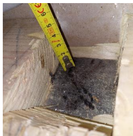
Kuva 73 Alaohjauspuu on 48 mm paksu ja sen alapuo- lella on bitumikermi, josta otettiin näyte haitta- aineanalyysiin.
