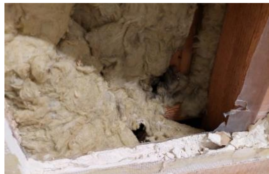
Kuva 31 Uudemman villalevyn takana oli vanhempaa villaa.
