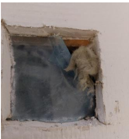
Kuva 36 Höyrinsulkuna on uudempi sininen muovi. Näyte otettiin villan ulkopinnasta.
