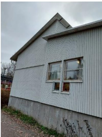
Kuva 13 Rakennuksen 2 koillispäädyssä sokkeli on korkea.
