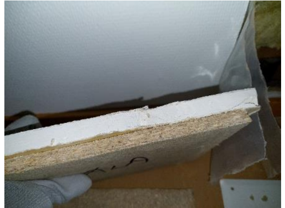
Kuva 39 Ulkoseinässä oli kipsilevyn takana myös puukuitulevy (10 mm).
