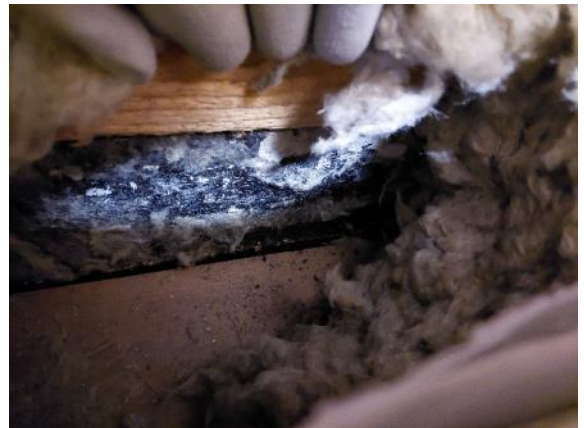
Kuva 47 Vaakariman alapuolella on betoninen sokkeli. Sokkelin sisäpinnassa on bitumisivelyä. Alaohjauspuu on noin 100 mm lattiapinnan alapuolella.
