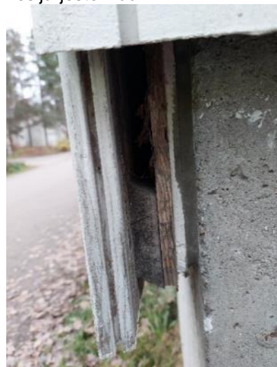
Kuva 14 Päädyssä on näkyvissä julkisivun takana oleva tuuletusrako: ohuen pystyriman jälkeen on vaakarimat ja sitten julkisivulauta.
