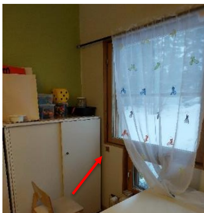
Kuva 60 US16 tilaan 1.26 ikkunan alle.
