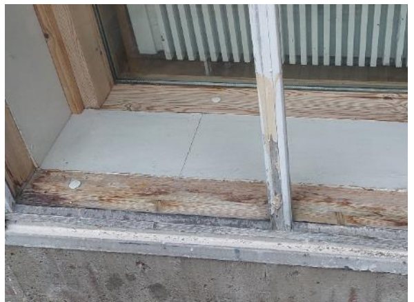
Kuva 20 Kiinteiden ikkunoiden välissä oli kosteusjälkiä.
