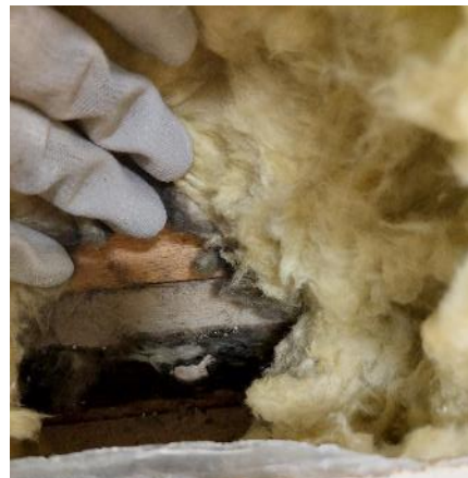
Kuva 53 Sokkelin bitumisively ei ulotu vaakalautoitukseen asti.
