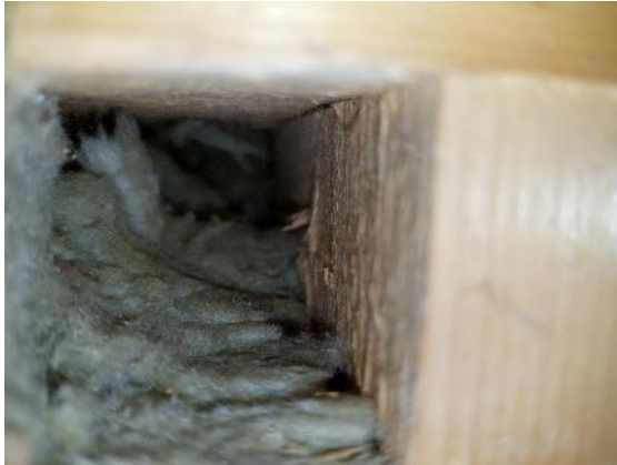
Kuva 62 Eristevillasta otettiin mikrobinäyte, jossa oli epäily vauriosta.
