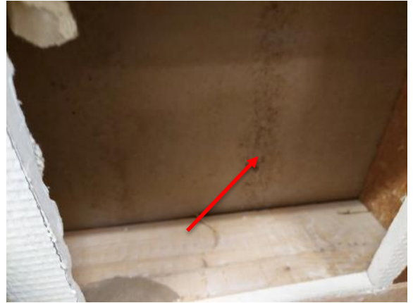
Kuva 69 Kipsilevyn paperi vaikutti kuivalta. Takaseinän paperissa on musta raita, mutta se voi olla teh-dasperäinen värivirhe.
