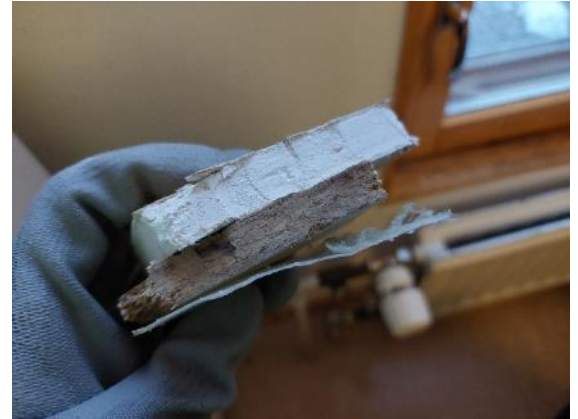
Kuva 63 Kipsilevyn jälkeen oli puukuitulevy ja sen takana läpinäkyvä höyrnsulkumuovi.
