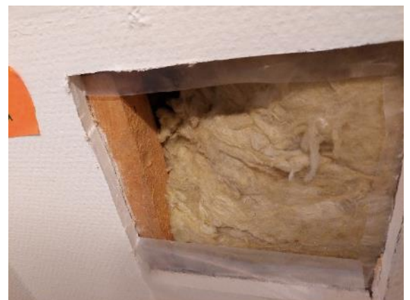
Kuva 43 US6 johtajan tilaan 1.07 ikkunan alapuolelle.
