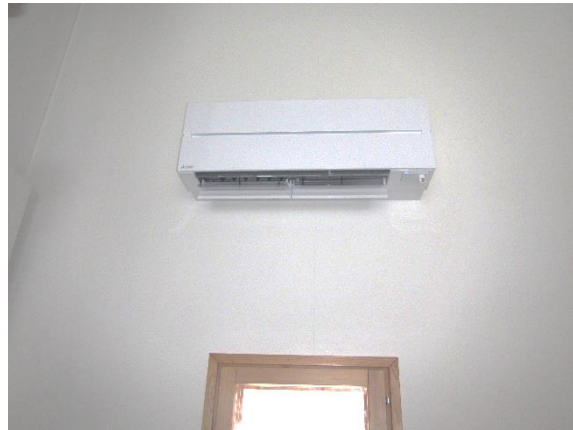
Kuva 28 Yhteistiloihin v 2023 asennettu ilmalämpöpumppu
