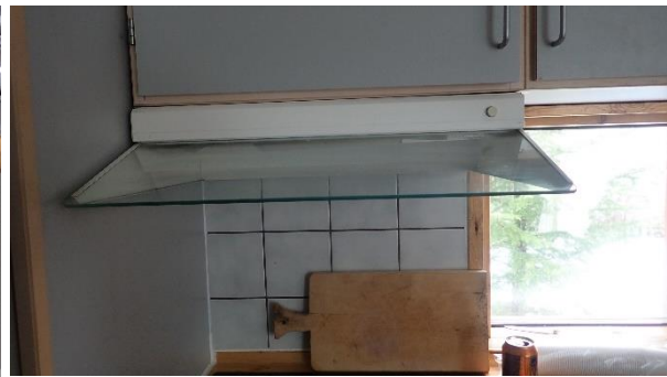
Kuva 26: Liesikupu on yhdistety poistoilmahormiin
