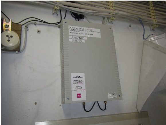
Kuva 53: Murtohälytintä on kytketty puhelinverkkoon
