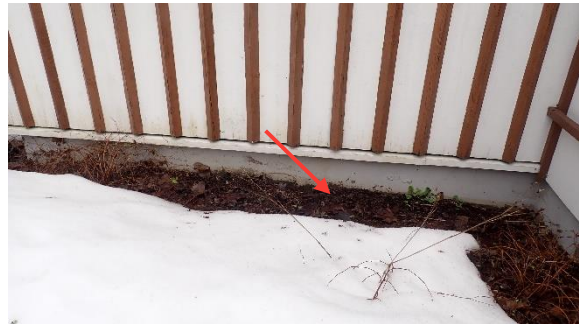
Kuva 4: Perusmuurielvytystä ei havaittu
