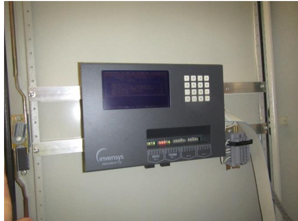
Kuva 54. Invensys (nykyinen Schneider) talotekniikan ohjauskeskus
