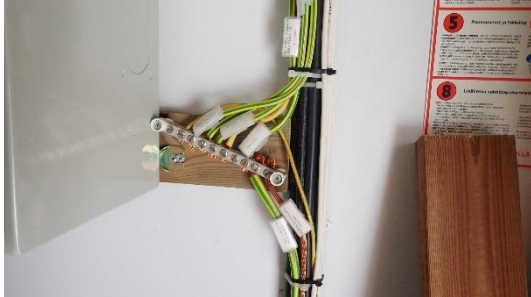
Kuva 44 Maadoitusjohdoissa on merkinnät
