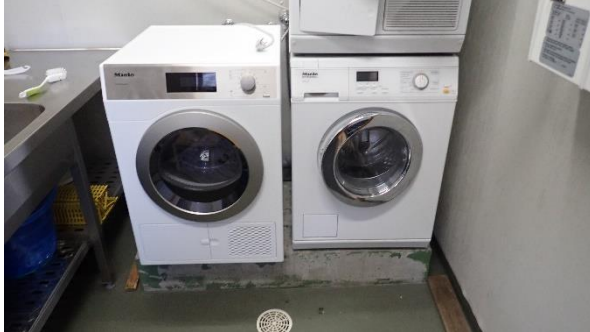
Kuva 19: Pesuvassa on pesukoneiden lisäksi kuivausrumpu
