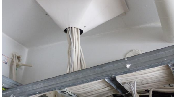
Kuva 46: Teknisen tilan kattolämmityksen johdotuksia.
