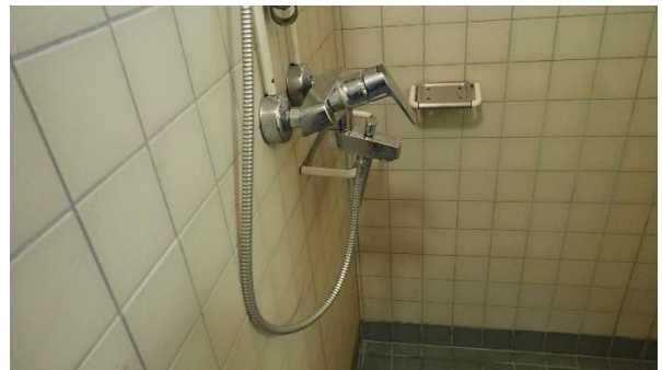
Kuva 20: Pesutilojen pintarakenteiden kunto todettiin heikoksi.
